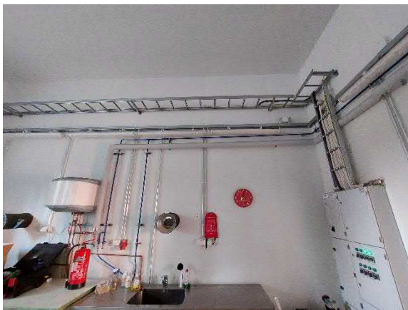
Sammutuspeite laajennusosan seinällä.
