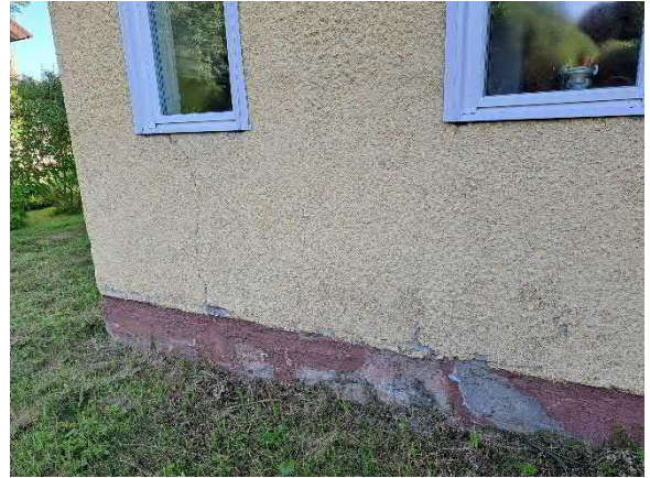
Alkuperäisen osan rappaus- ja sokkeliosissa vaurioita
