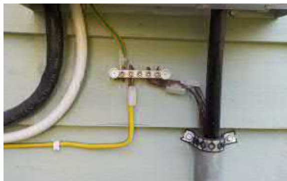
Maadoituskisko pääkeskuksen yhteydessä
