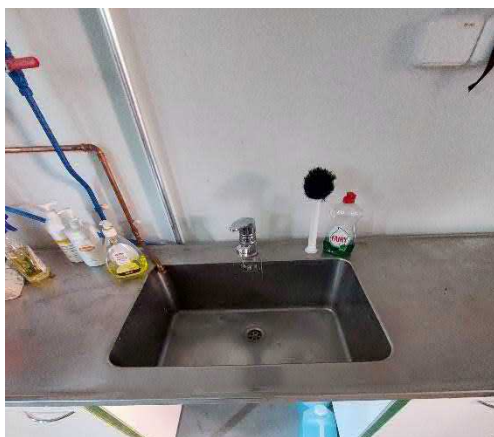
Kiinteistön laajennusosan pesuallashana.
