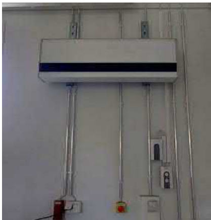
Puhallinkonvektori säätiminen uudemmassa kalustohallissa
