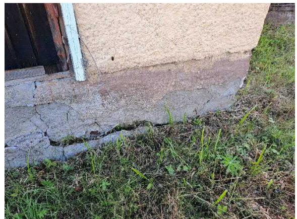
Alkuperäisen osan sokkelirakenteissa vaurioita
