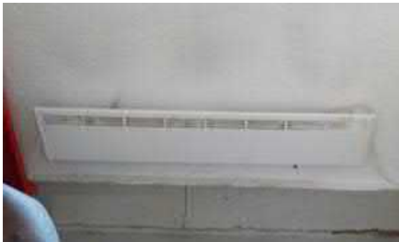
Sähkölämmitin vanhemmassa kalustohallissa
