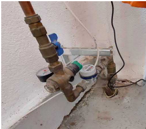
Kiinteistön päävesimittari ja sulkuventtiilit.
