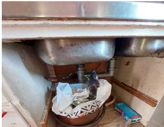
Kiinteistön alkuperäisen rakennusosan pesualtaan viemärointi.
