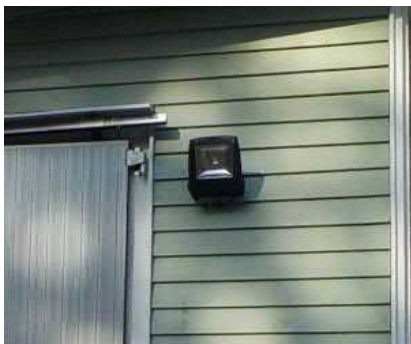
LED-valonheitin seinään asennettuna
