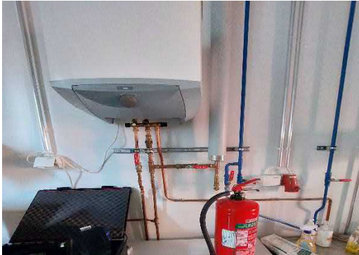
Kiinteistön laajennusosan lämpimän käyttöveden varaaja ja käyttövesijohtoja.
