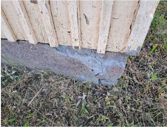
Vaurioita alkuperäisen osan sokkeli- ja puuosissa
