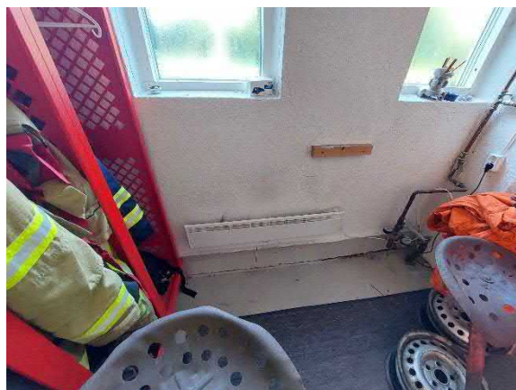
Kiinteistön alkuperäisen rakennusosan sähköpatteri.
