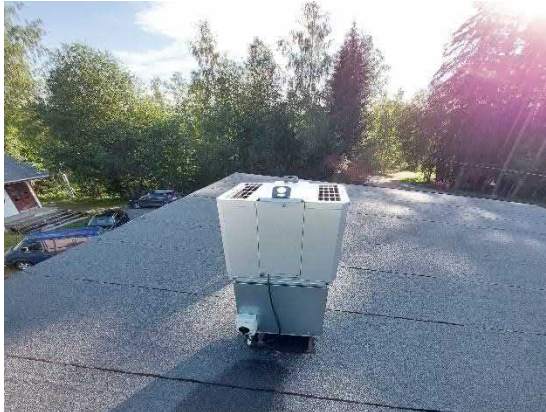
Kiinteistön laajennusosan huippuimuri PK01.
