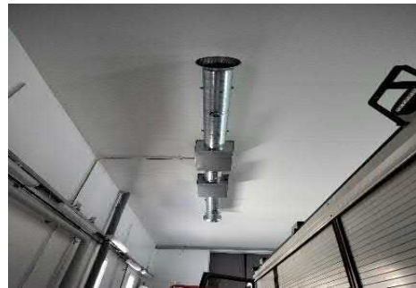
Kiinteistön laajennusosan poistokanavisto.
