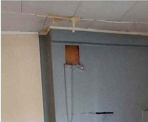
Tulpattu painovoimainen poistosäleikkö yläkerrassa.
