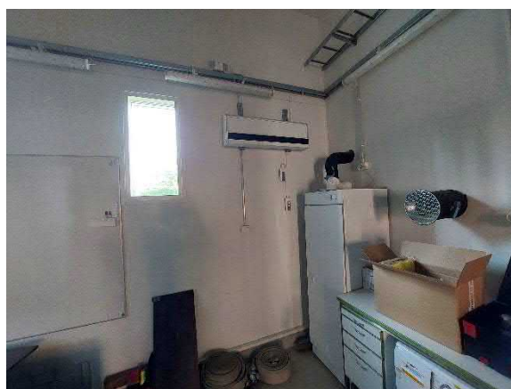
Kiinteistön laajennusosan sähkölämmitteinen puhallinkonvektori.
