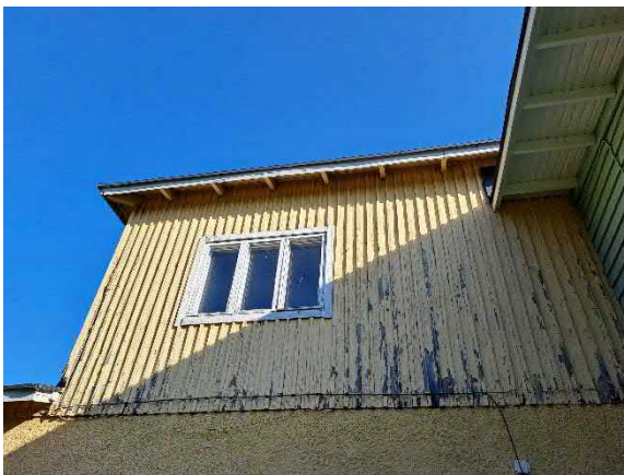
Alkuperäisen osan puuosissa vaurioita
