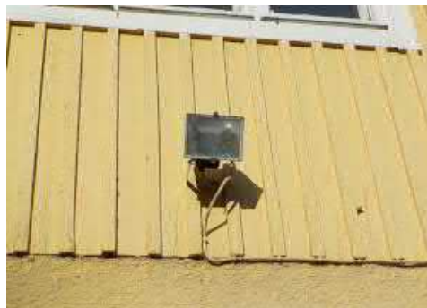
Halogeenivalonheitin seinään asennettuna
