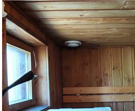
Alkuperäisen rakennusosan saunan poistoilmaventtiili.
