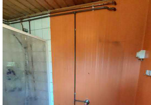
Kiinteistön alkuperäisen rakennusosan saneerattuja käyttövesijohtoja pesuhuoneessa.
